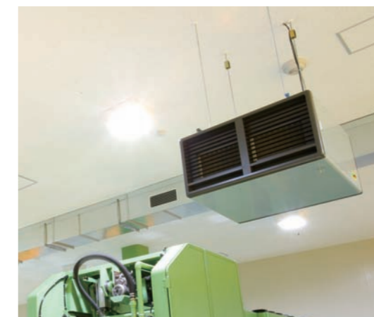
三段階のフィルターを通して清浄な外気を取り込む空調システム
